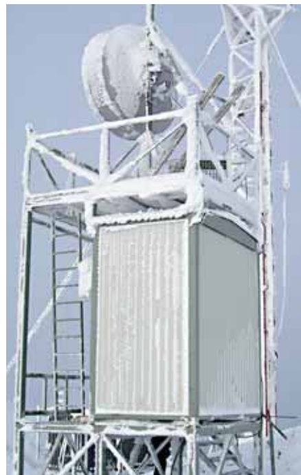
КАС в контейнерном исполнении
