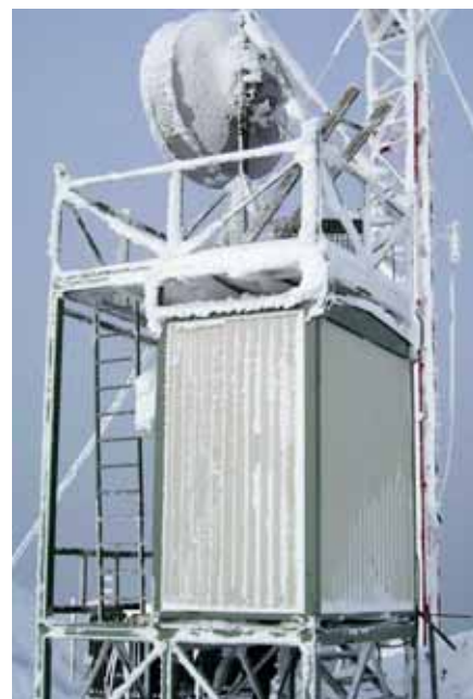
Модуль-контейнер унифицированной серии на объекте Заказчика
